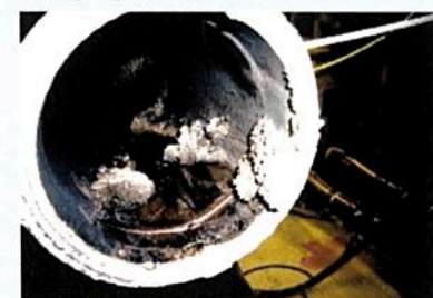
AdBlue® indsprøjtet. Materialeaflejring ved rørbøjning, SCR-indgang.
